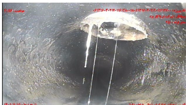
شماره تصویر ۵ عنوان موقعیت ۲۱۰۹۶ کد اتصال جانبی معيوب / اتصال معيوب انشعاب
