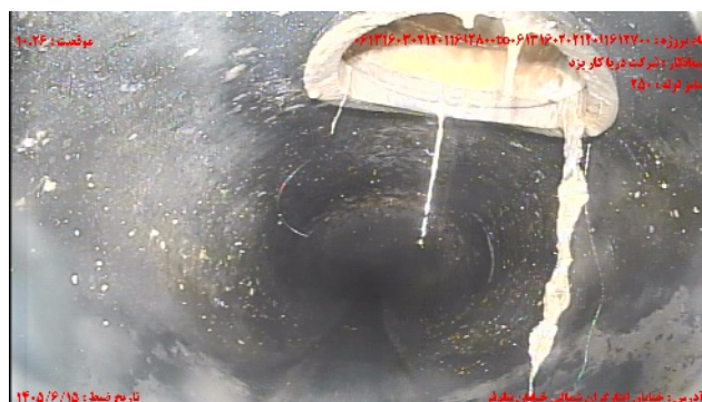
شماره تصویر ۴ عنوان موقعیت ۱۰۰۲۶ کد اتصال جانبی معيوب / اتصال معيوب انشعاب
